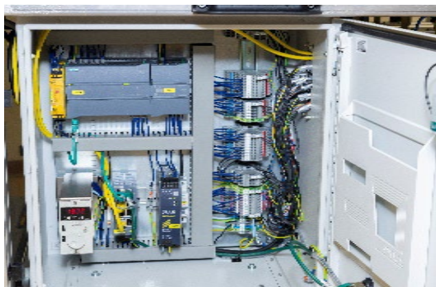
Schaltschrank mit integrierter SPS
